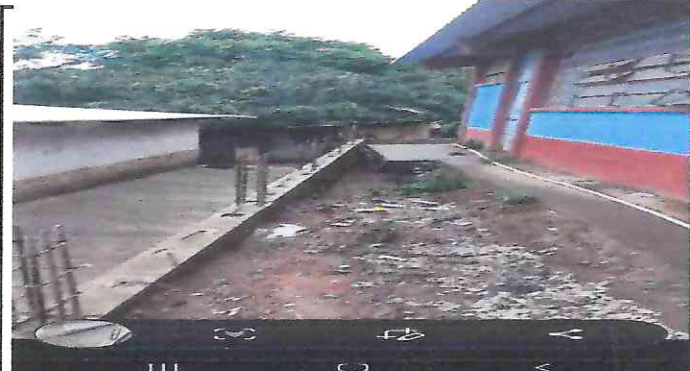
Foto 4: Muro perimetral con problemas de inseguridad
