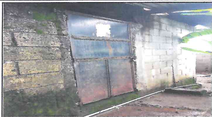
Puerta de servicios sanitarios en mal estado
