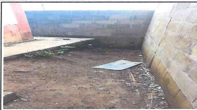
Foto 2: Muro perimetral debilitado por las lluvias
