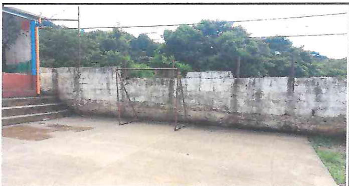
Foto 3: Muro perimetral debilitado
